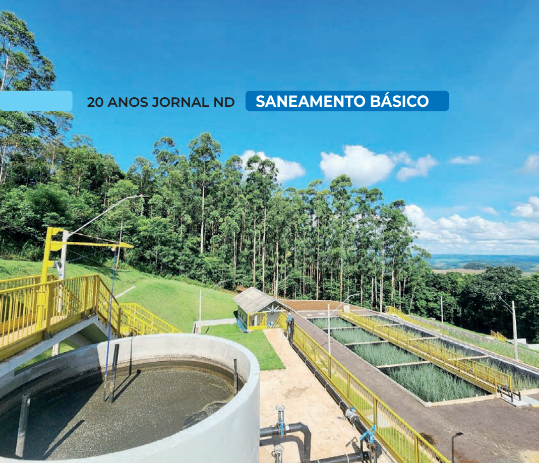
Unidade de Gerenciamento de Lodo em Descanso. Estruturas como essa serão destino do esgoto coletado no programa Esgotamento sobre Rodas
