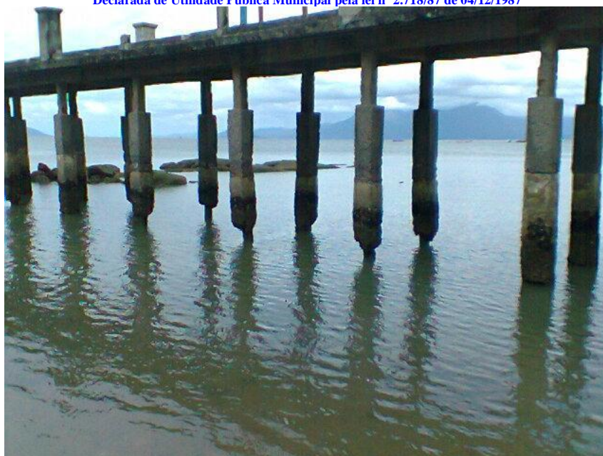
FIGURA 3 - Pilares do Trapiche, com sinais de desprendimento de placas de cobertura
